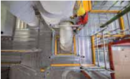
Las aberturas y pasos para tuberías se rodean con plataformas, barandillas y rodapiés estándar.
